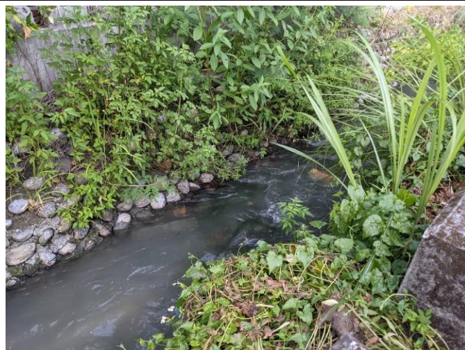
漿砌護岸破損處長出許多植生
