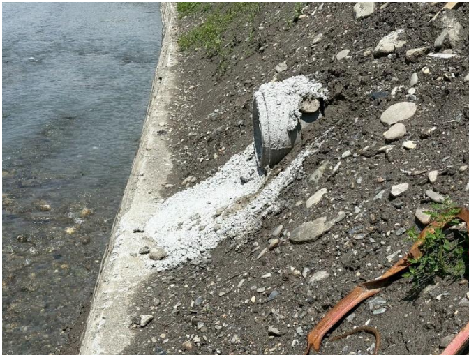
護岸工程水泥施作超出工程範圍
