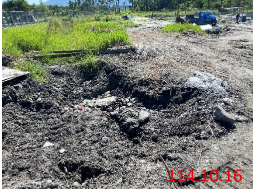
工區土坑人工廢棄物堆置
